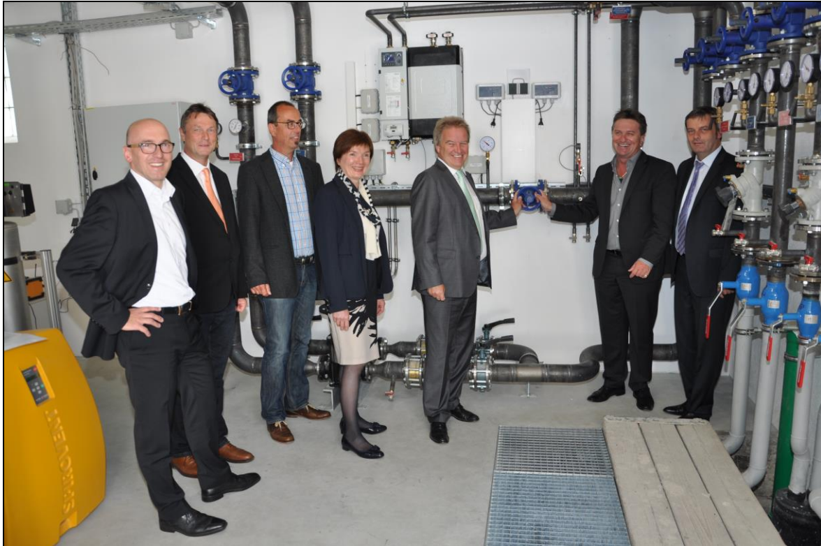
Einweihung Energiezentrale: Vorstände der BEE die Herren Stehle, Knappe und Böhme, Frau Meschenmoser, Minister Untersteller, Herr Lucha und BM Obermeier
